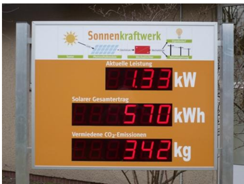
Abb.4 Anzeige der Leistungsdaten der Photovoltaikanlage
